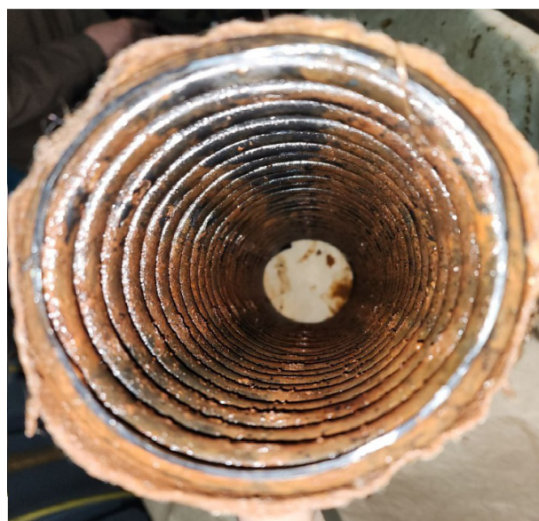
Труба 113 – после промывки
