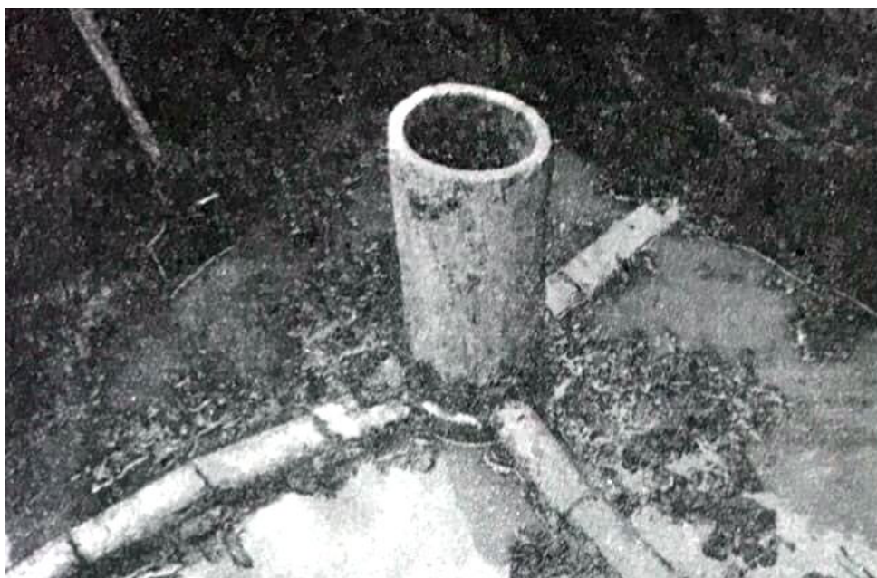
Рис. 6. Смотровой колодец-отстойник, выполненный из двух гончарных труб диаметром 300 мм
