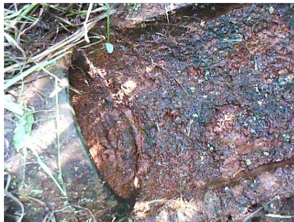
Рис. 3. Осадки песчано-охристых отложений в лотке дренажного устья дрены № 110
