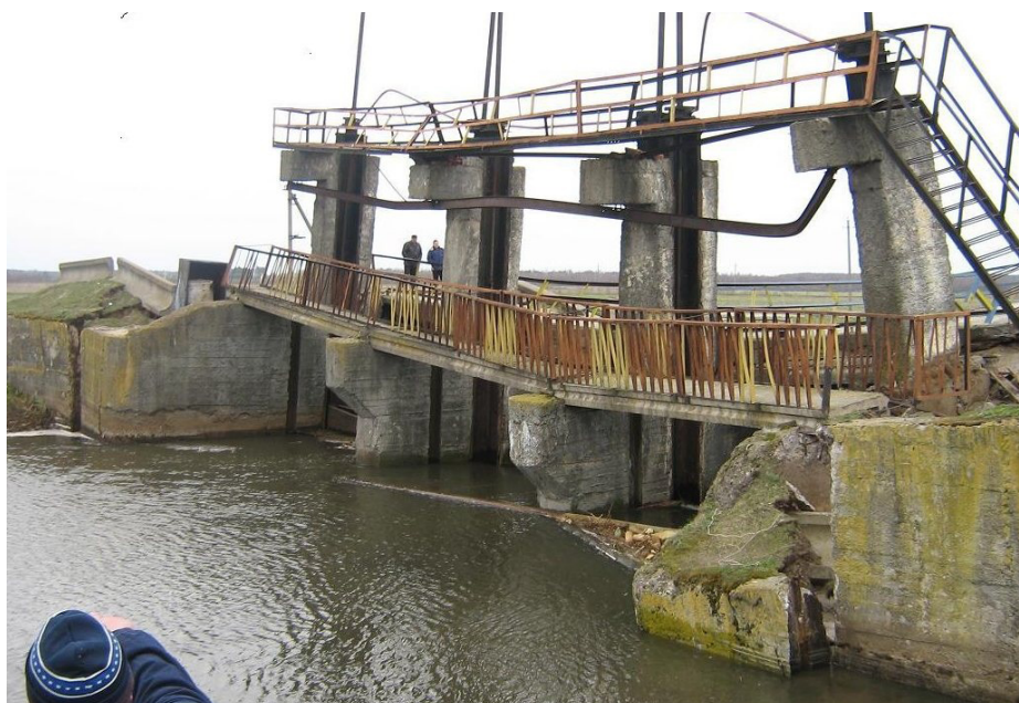
Рис. 15. Просадка и видимая деформация водосбросных сооружений (Любашевское водохранилище)
