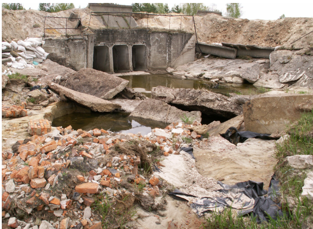
Рис. 1. Авария на гидроузле водохранилища Млынок
