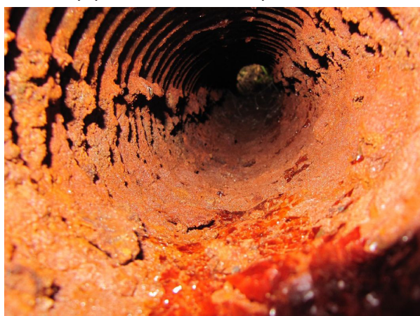
Рис. 4. Заиление и заохривание дрены № 111
