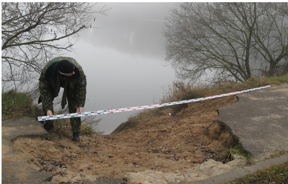
Рис. 7. Измерение размеров локального повреждения неукрепленного верхового откоса плотины (водохранилище Вяча)
