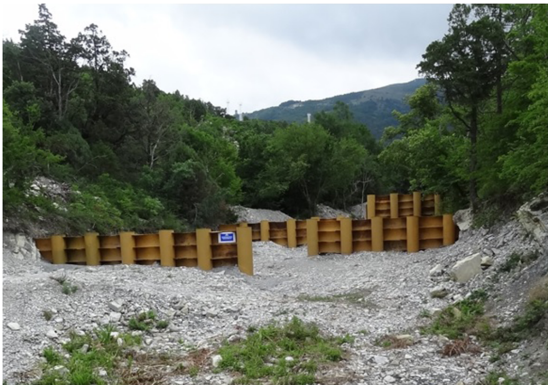
Рис. 4. Общий вид селеулавливающих гребенок инженерной защиты 14-го ущелья
