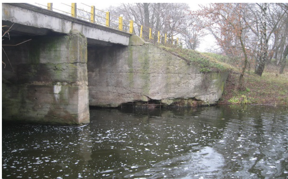
Рис. 14. Повреждение (скол бетона) водосбросных сооружений (водохранилище около Острошицкого Городка)
