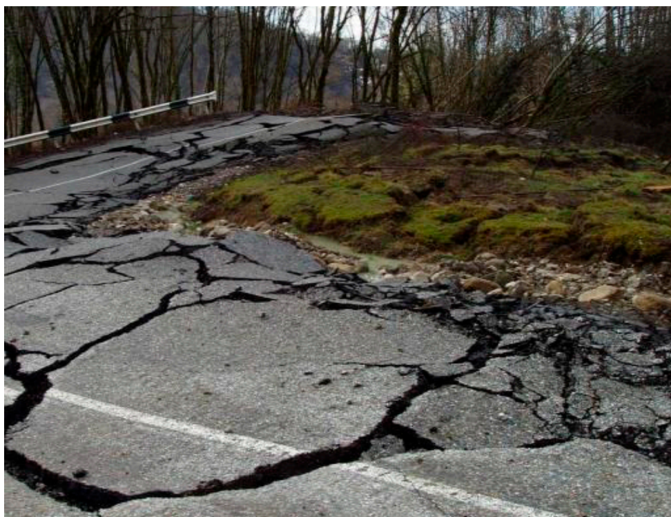
Рис. 3. Оползень в п. Хоста
