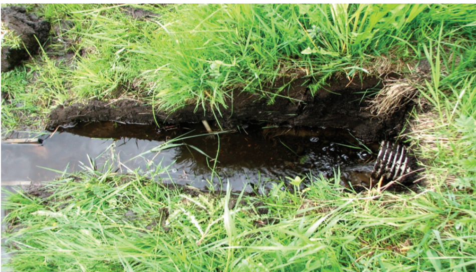
Рисунок 5 – Хризотилцементное дренажное устьевое сооружение со съехавшим по откосу устьевым лотком и трубой (труба погребена в иле ниже лотка, на фото не видна, но прощупывается зондом)
