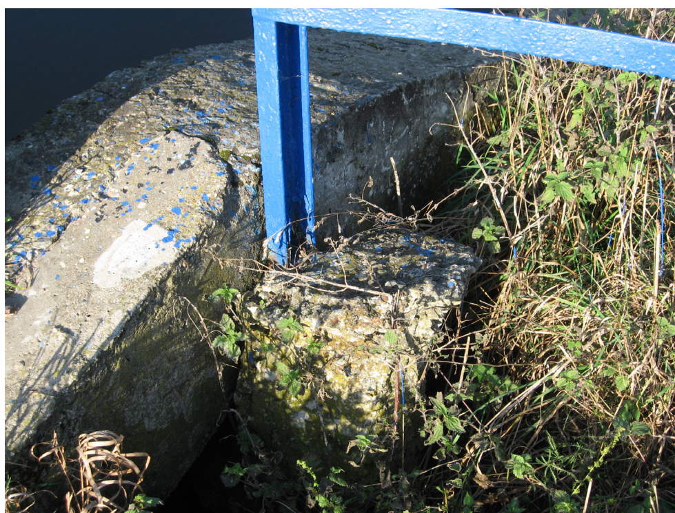
Рис. 5. Провалы грунта в примыкании левобережного устоя
