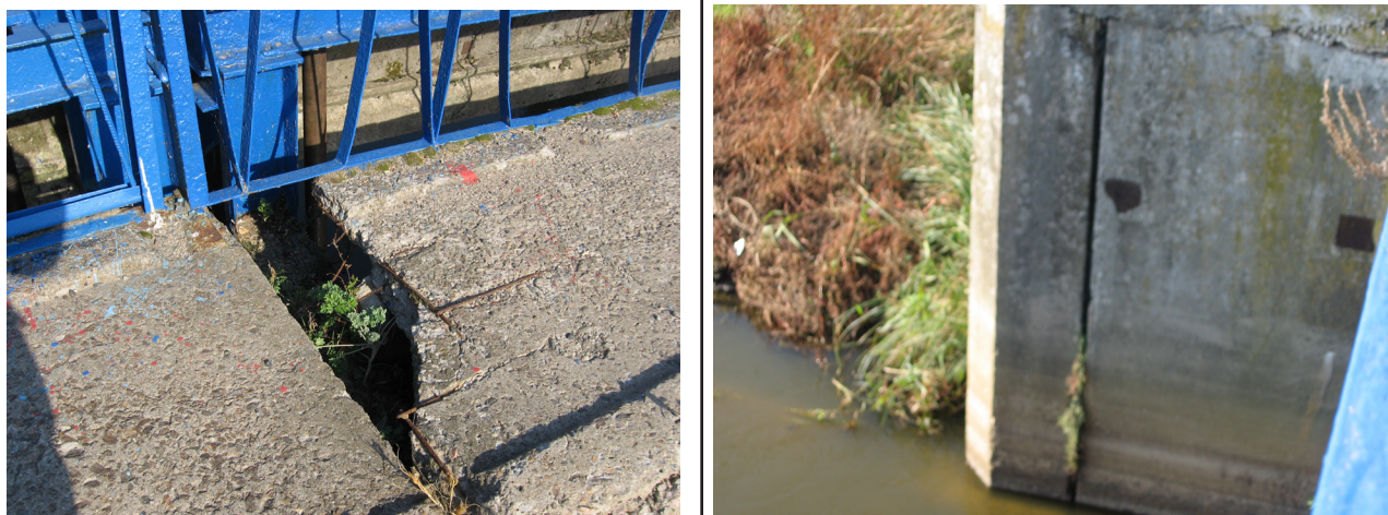
Рис. 4. Разрушение плиты служебного мостика и уплотнения конструктивного шва
