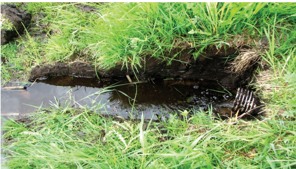
Рисунок 5 – Хризотилцементное дренажное устьевое сооружение со съехавшим по откосу устьевым лотком и трубой (труба погребена в иле ниже лотка, на фото не видна, но прощупывается зондом)
