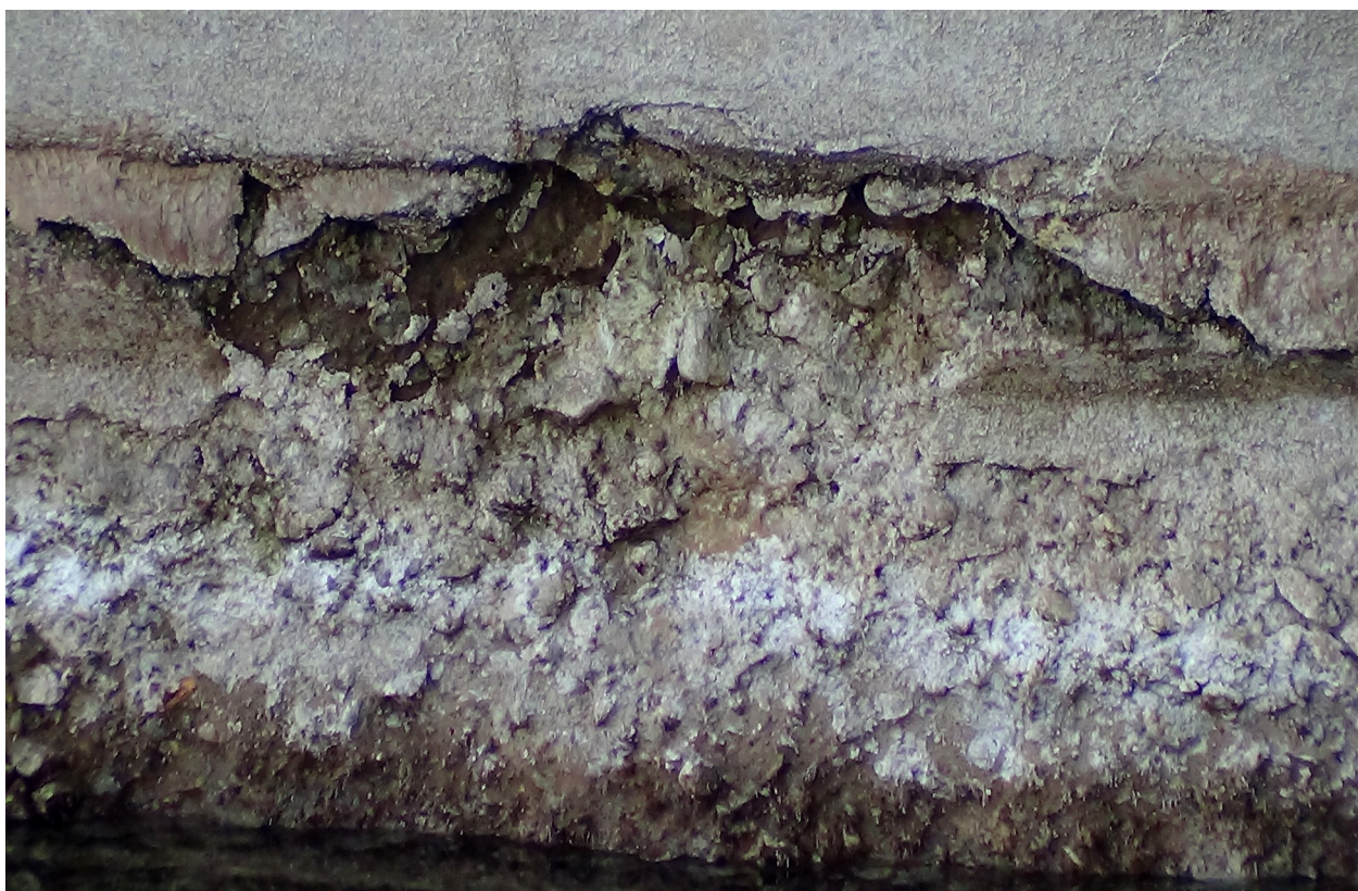
Рисунок 4 – Поверхностное разрушение бетона бычка
