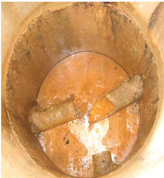
Рисунок 1 – Дефекты трубчатого дренажа
