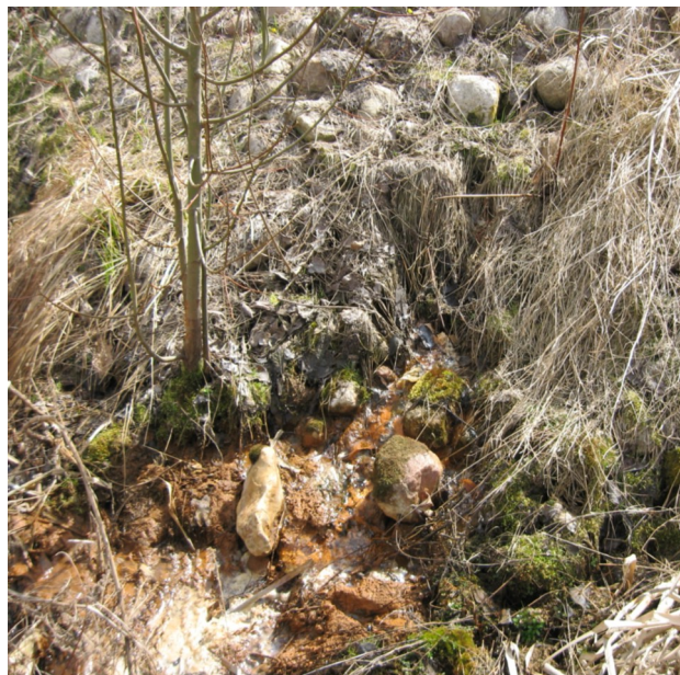
Рисунок 2 – Выход фильтрационного потока на низовой откос плотины ГЭС "Алешино"
