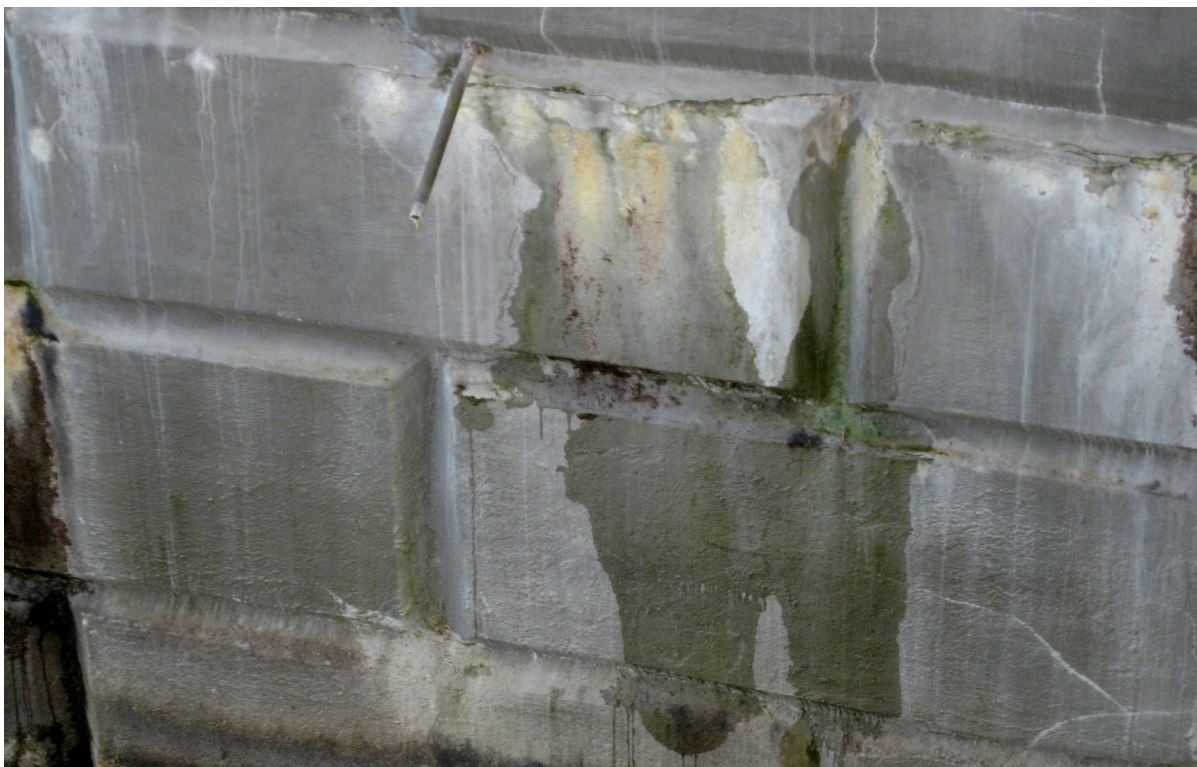
Рисунок 3 – Подтеки на низовом открьлке правобережного устоя
