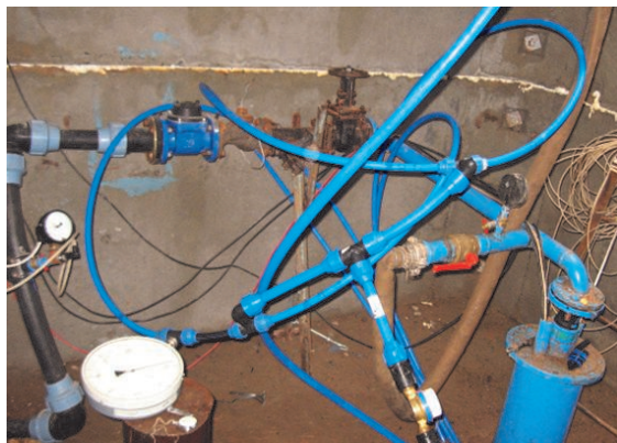
Рисунок 46 – Устье скважины с обвязкой при закачке воды в четыре циркуляционные трубки.
