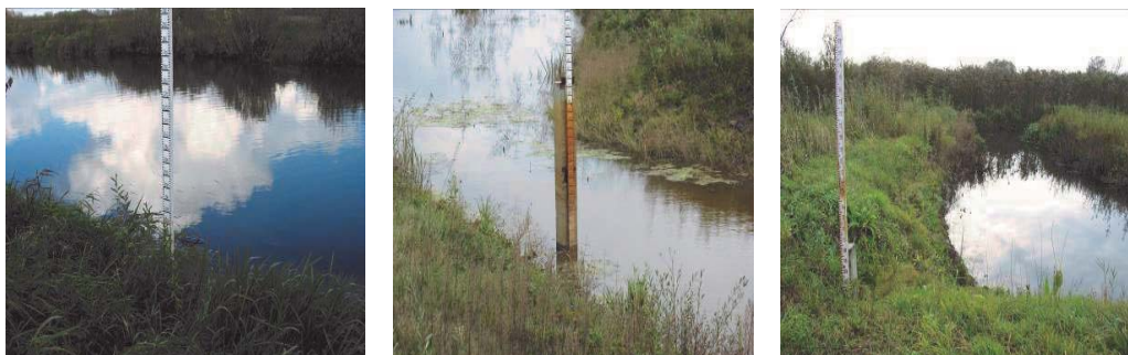
Рисунок 6 – Варианты размещения и состояние водомерных реек в верхнем бьефе насосных станций
