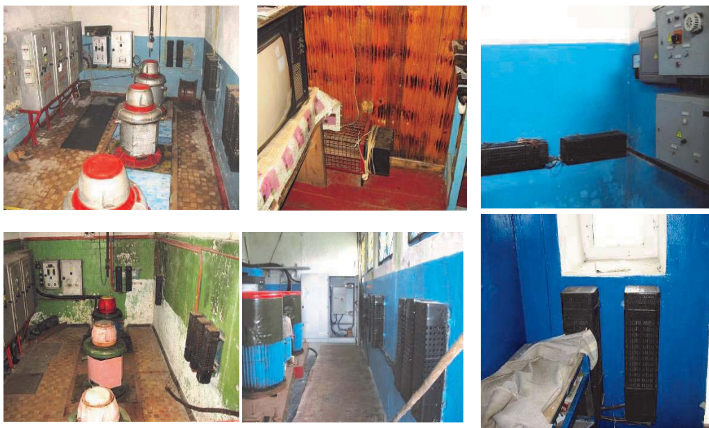
Рисунок 3- Использование электроотопления на польдерных насосных станциях в настоящее время.
