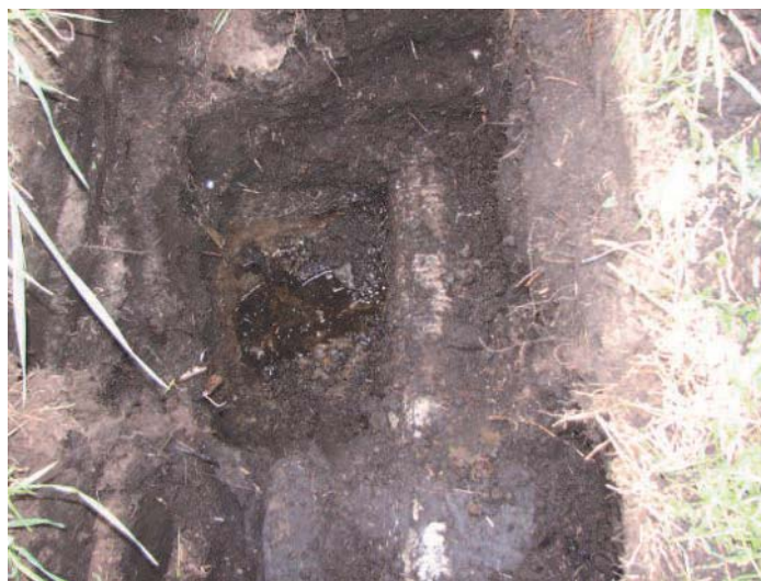
Рисунок 1 — Вид сверху в шурфе вскрытого дренажного коллектора № 21 на объекте «Железинка», Пуховичского района, Минской области.
