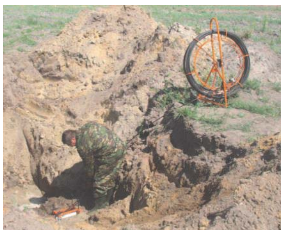
Рисунок 2 — Оценка внутреннего состояния коллектора устройством ОД-100 с применением муфты промывочной МПГ-1
