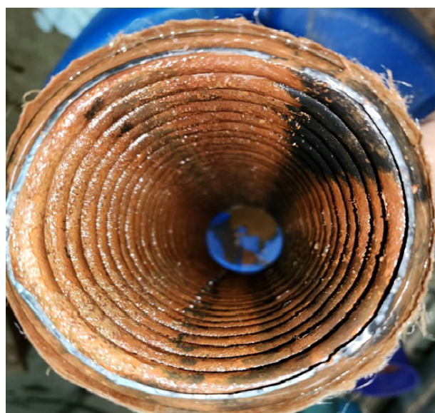
Труба 109 – после промывки
