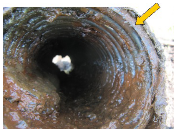
Рис. 1. Внутренняя полость изъятых образцов дренажной трубы дрены № 109
