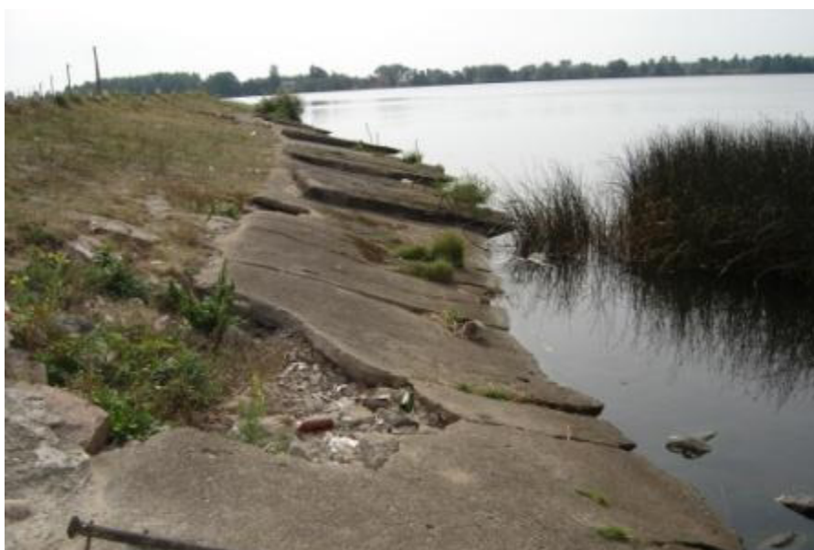
Рис. 11. Разрушение крепления берега (Чигиринское водохранилище)
