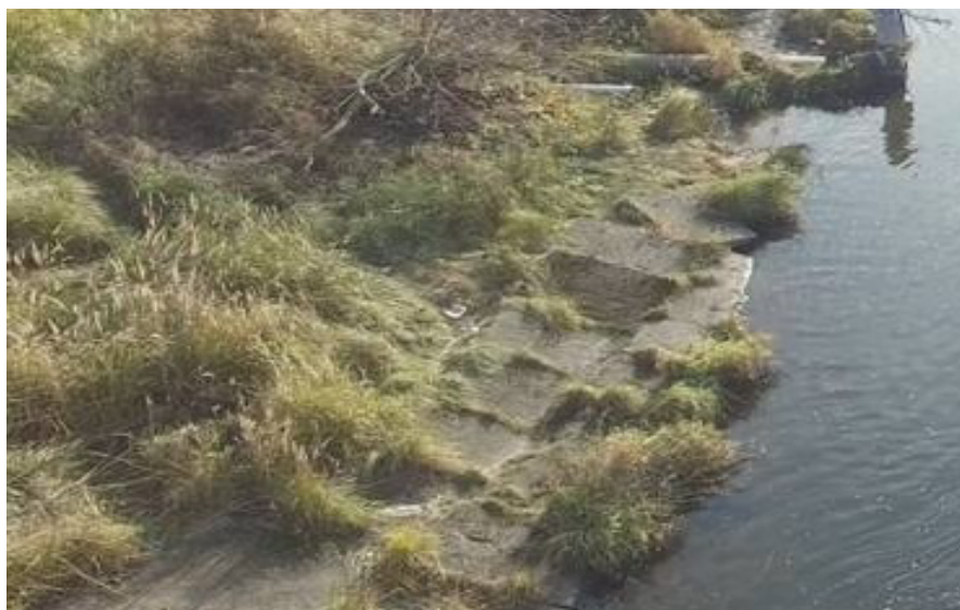
Рис. 10. Разрушение крепления берега на Дубровском водохранилище (снимок с беспилотника)
