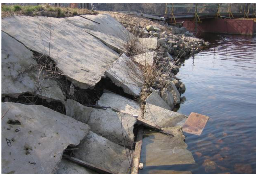
Рис. 12. Разрушение крепления берега (Лепельское водохранилище)
