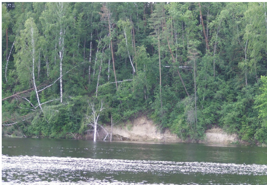
Рис. 4. Разрушенный берег с упавшими в воду деревьями (водохранилище Гродненской ГЭС)
