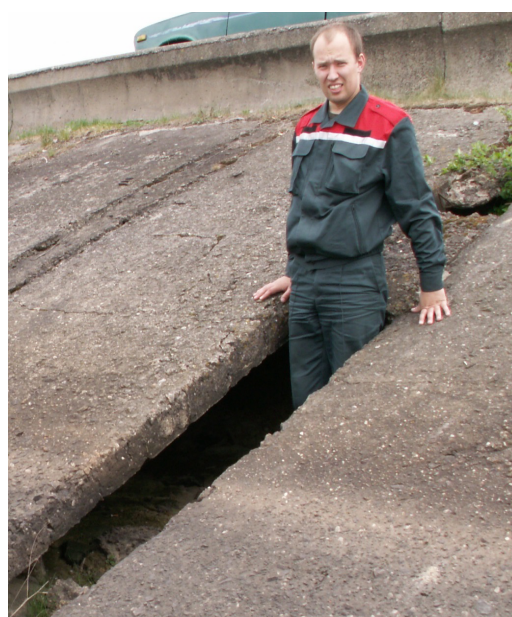
Рис. 9. Вынос грунта из-под плит крепления откоса плотины (водохранилище Млынок)
