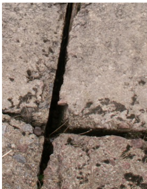
Рис. 8. Раскрытие швов между плитами крепления на водохранилище Зельва
