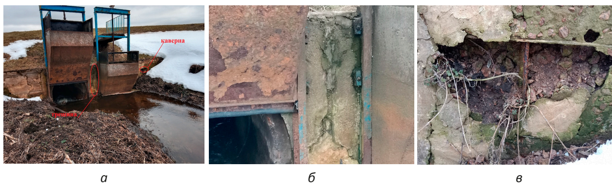
Рис. 1. Характерные дефекты шлюза-регулятора: а – общий вид шлюза-регулятора; б – трещина; в – каверна
