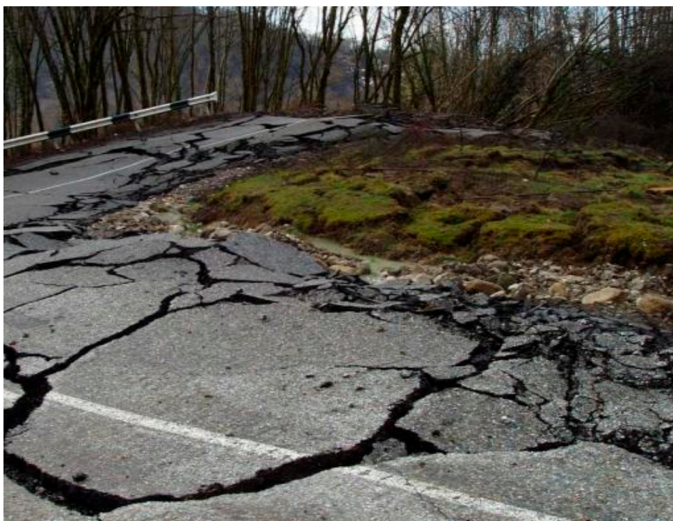
Рис. 3. Оползень в п. Хоста
