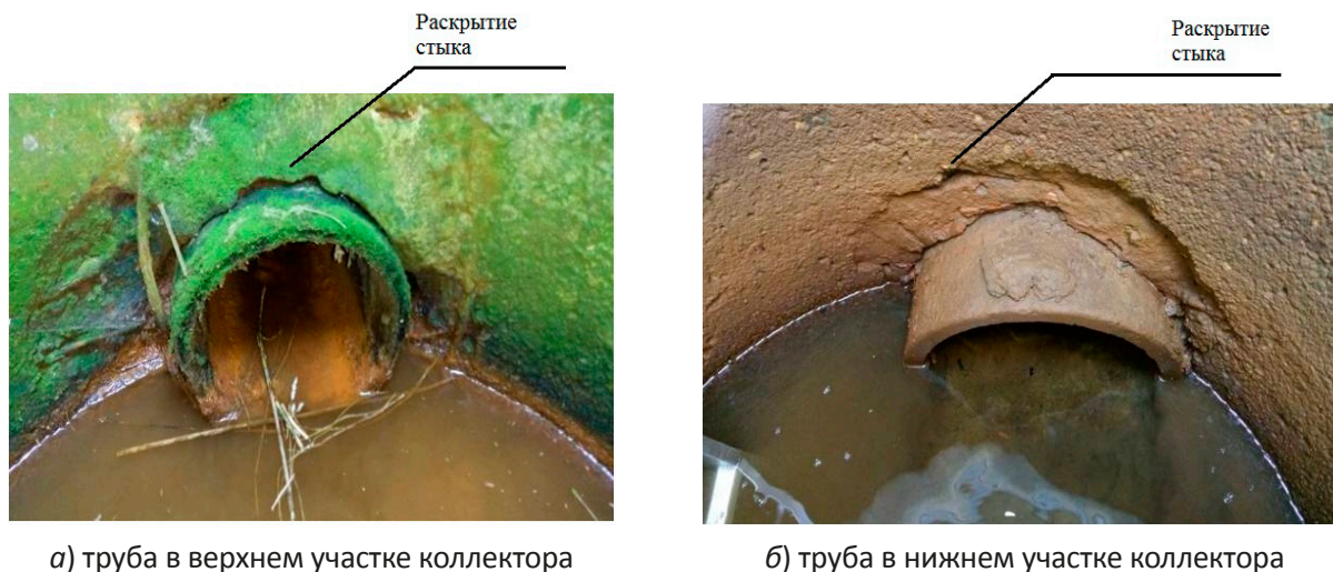
Рис. 4. Заиливание трубопровода большого диаметра АК-1-1 из асбестоцементных труб на мелиоративной системе «Молотковичи» (2023 г.)
