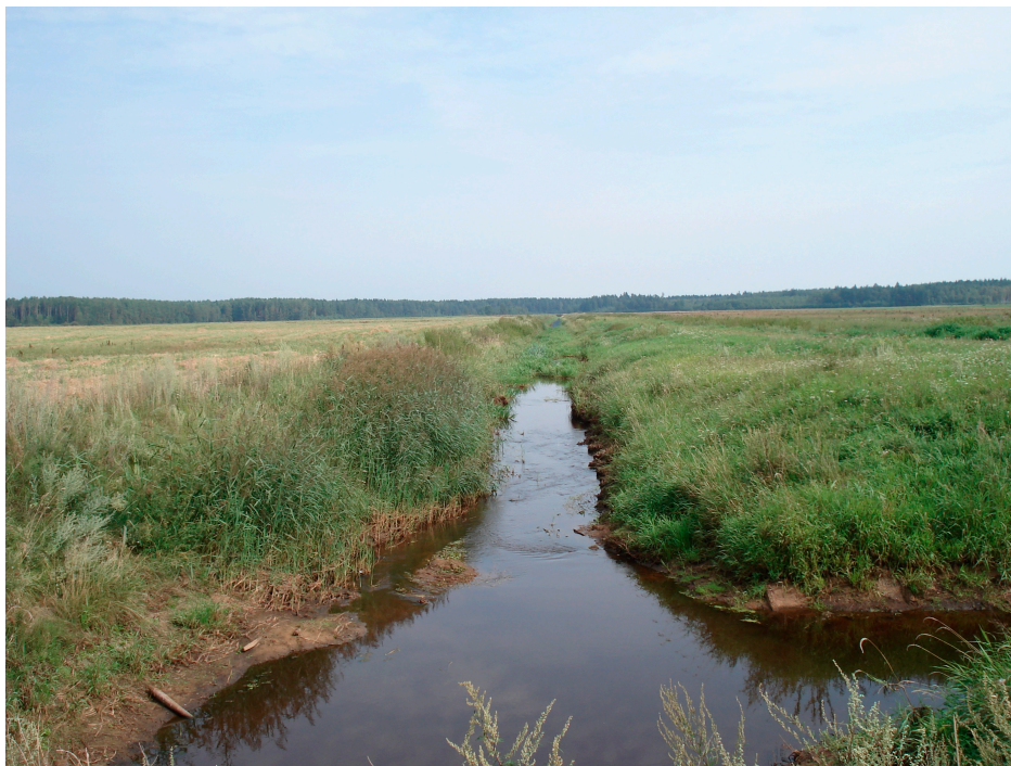
Рисунок. Деформация и обрушение откосов канала магистрального канала мелиоративной системы (Смолевичский р-н Минской обл.)
