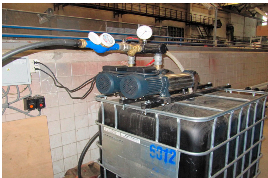
Рис. 4. Устройство подачи воды (общий вид)
